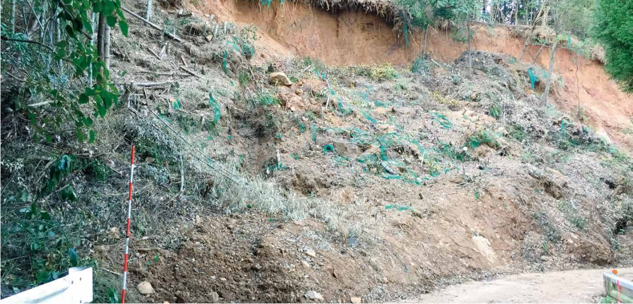
① 林道高木川内線の地すべり
