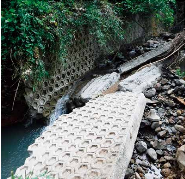
④ 瓦川内の岩屋川内川護岸崩落等
