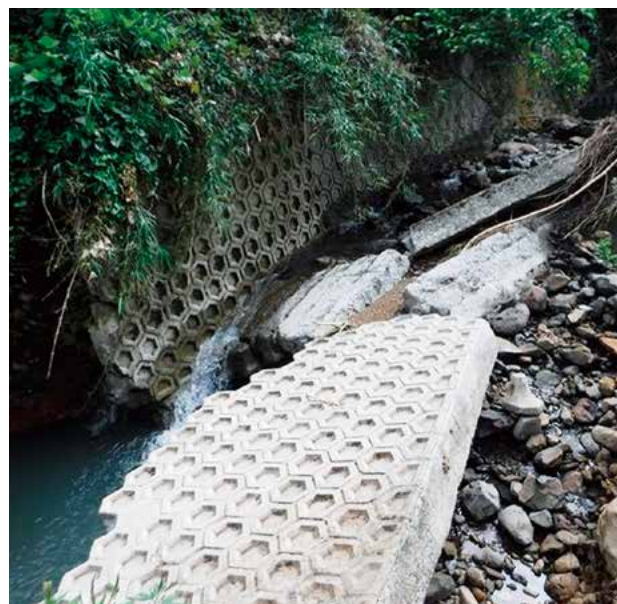
④ 瓦川内の岩屋川内川護岸崩落等
