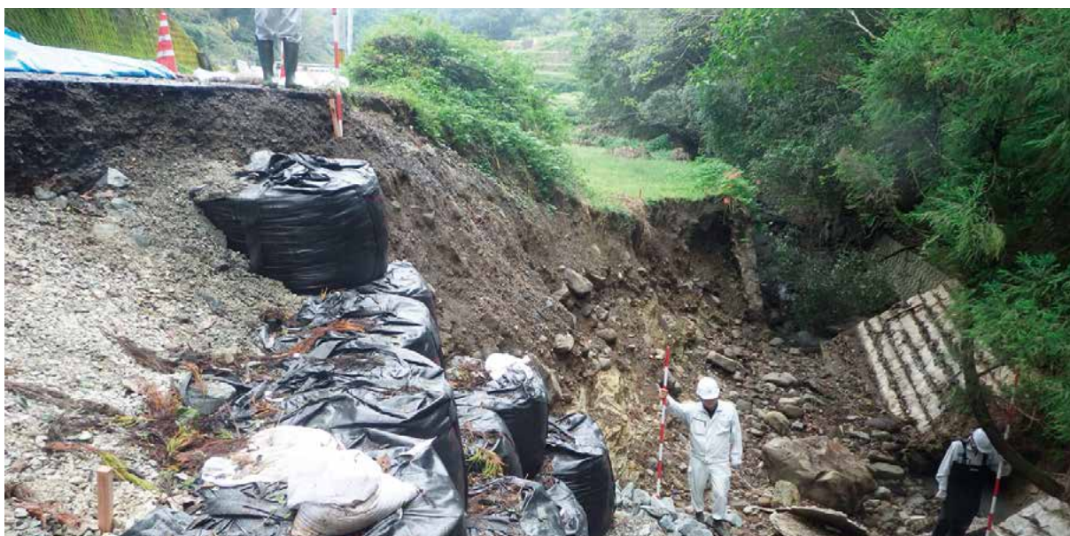
⑤ 市道宮ノ前・天ヶ瀬・井上線の法面崩落 一般車両の通行止めが続く
