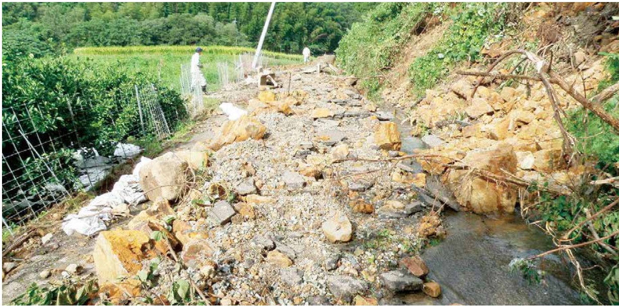
⑥南多久町駄道の地すべりによる農道被害
