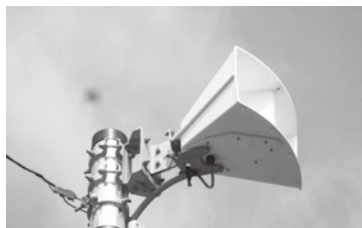
▲屋外放送設備
