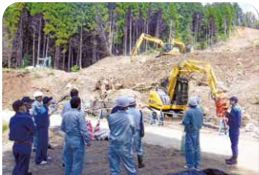
▲災害危険箇所を各機関が確認しました
