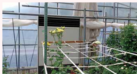
ヒートポンプ
