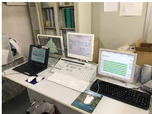
庁舎内防災システム
